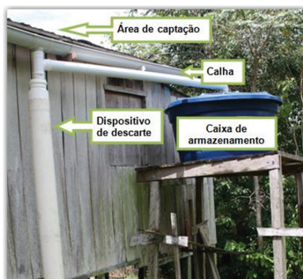
Figura 1. Sistema de captação da água da chuva instalado em uma residência da comunidade Julião – RDS Tupé.
